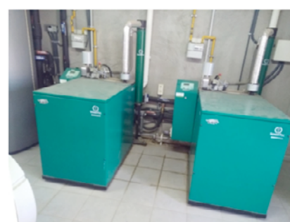
Calderas de cogeneración
